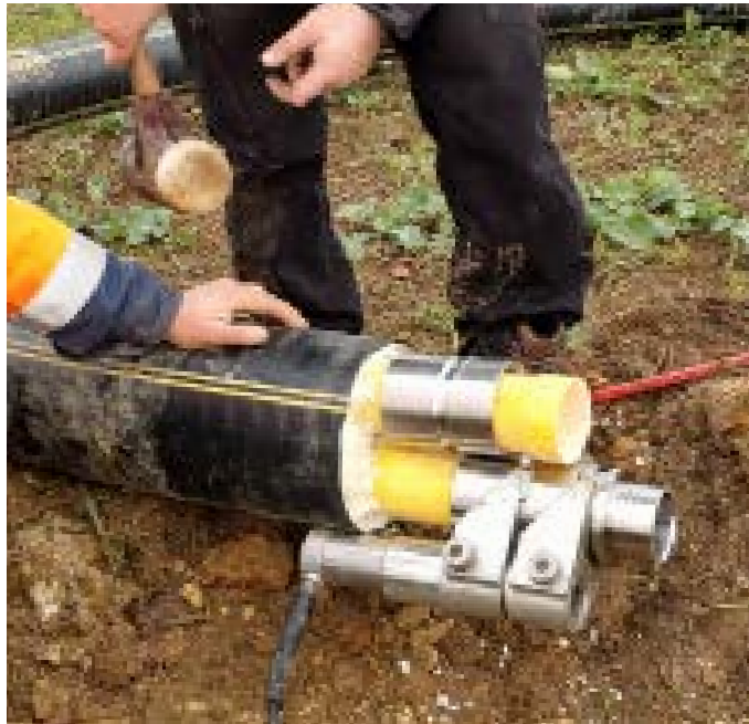
Um zwei Leitung miteinander zu verbinden, werden die Anschlüsse mit entsprechenden Spezialwerkzeugen hydraulisch verpresst.
