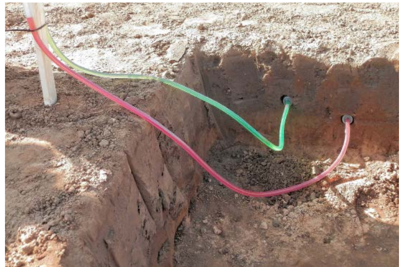
Die mit Wasser gefüllten Bodensonden wurden in 20 und 30 cm Tiefe horizontal verlegt und über Schläuche an einer Steigleitung montiert.
